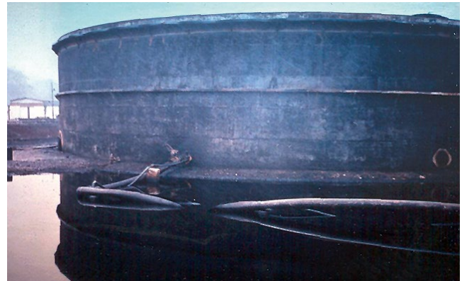
FIGURA 7 Fuoriuscita di liquido dalla sommità di un serbatoio cilindrico semi-interrato a causa dello sloshing
