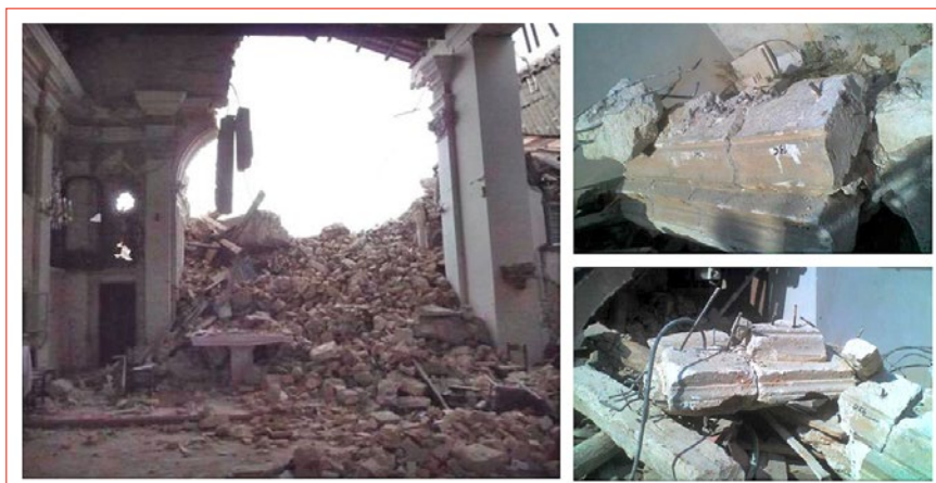
FIGURA 6 Chiesa di San Pietro Apostolo Onna (AQ), 2009, terremoto de L'Aquila: particolare dell'area di crollo invasa dalle macerie in corrispondenza della zona absidale e presbiteriale; intervento con cuciture armate risultato inefficace
