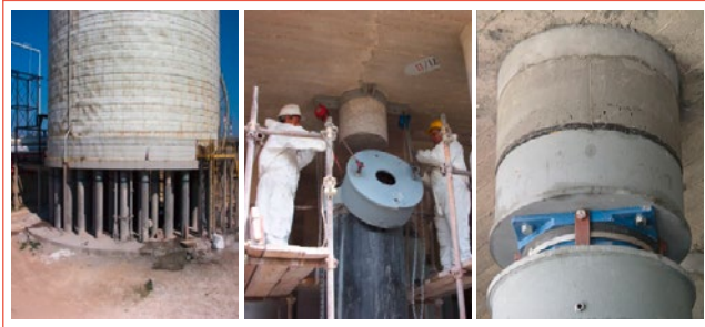
FIGURA 13 Uno dei tre serbatoi della Società Polimeri Europa del Gruppo ENI situati a Priolo, che furono adeguati sismicamente mediante isolatori statunitensi FPS negli anni 2005-2008, ed un FPS durante e dopo la sua installazione; questa è l'unica applicazione italiana dell'isolamento ad impianti e componenti chimici RIR nota allo scrivente (prima del sisma in Abruzzo del 2009 gli risultava anche l'unica applicazione in Italia di isolatori CSS) Fonte: Martelli et al., 2014a
