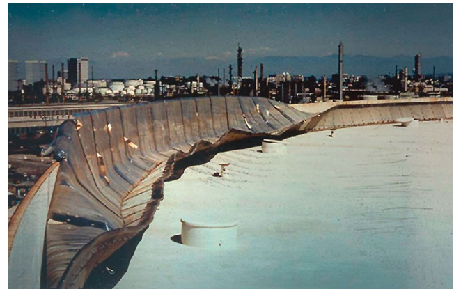
FIGURA 8 Danneggiamento del tetto di un serbatoio cilindrico a causa dello sloshing
