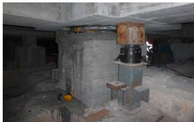
FIGURA 16 Posizionamento dell'isolatore (Edificio Bifamiliare)
